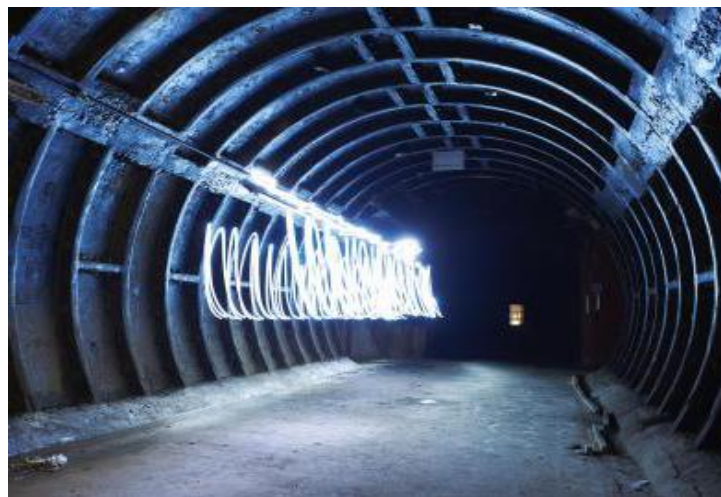
隧道照明示例
