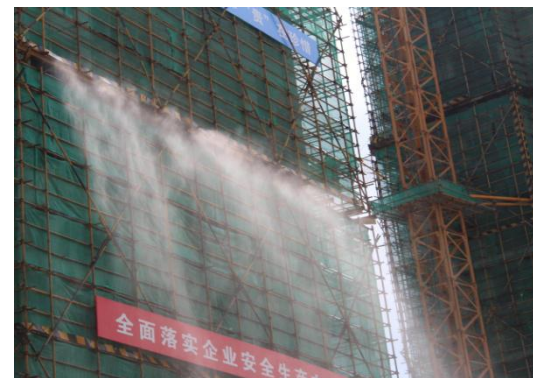
脚手架喷淋实景图
