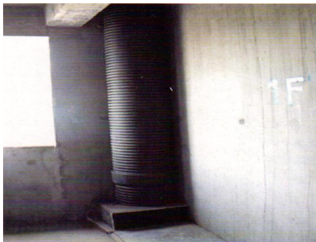
建筑垃圾楼层运输管道
