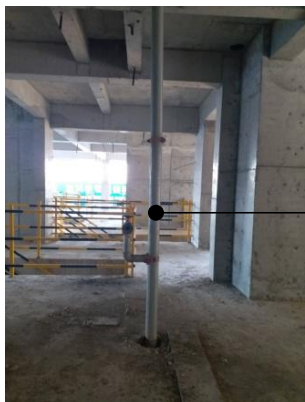
喷淋系统立管
